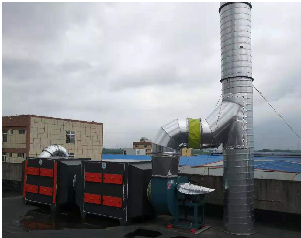
图 4.1-8 二级活性炭吸附装置及 P1 排气筒
