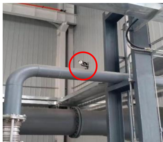
图 4.2-9 空分装置区视频监控器
