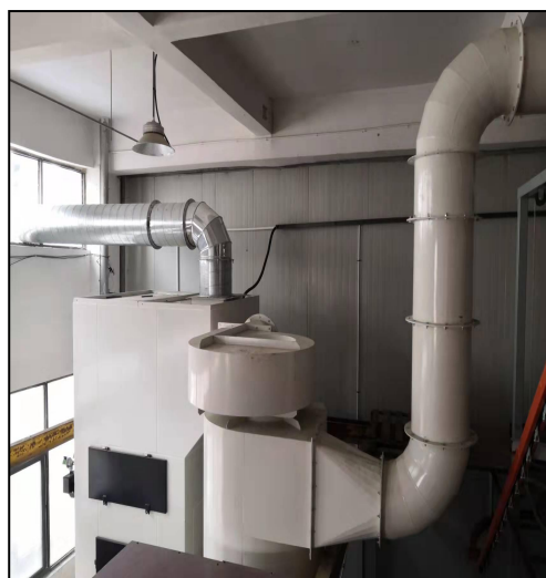
图 4.1-13 旋风除尘器集气管道
