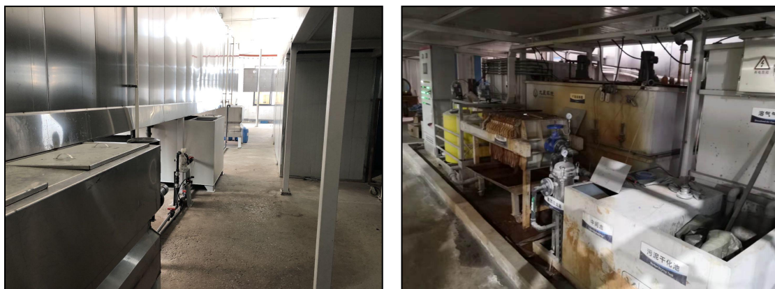
图 4.1-3 厂区污水处理站
