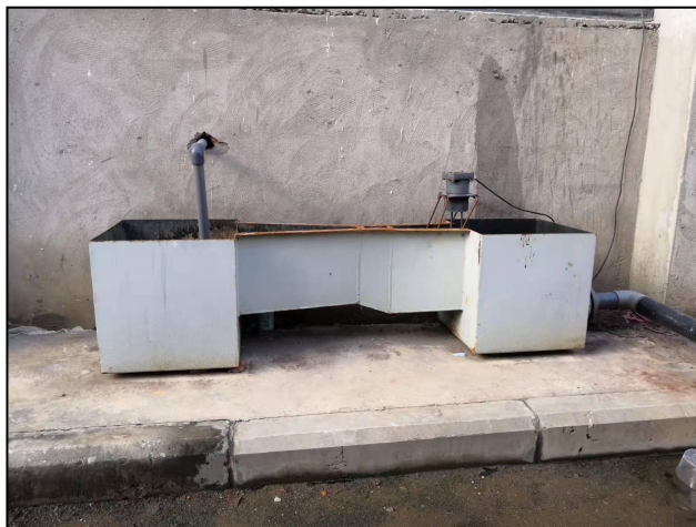
图 4.1-4 项目区规范化污水排口
