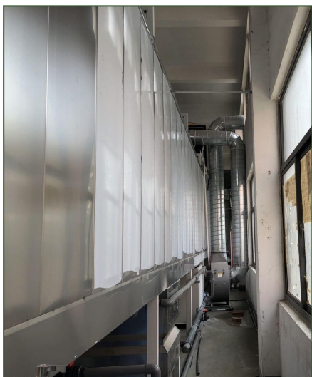
图 4.1-9 二级活性炭吸附装置集气管道
