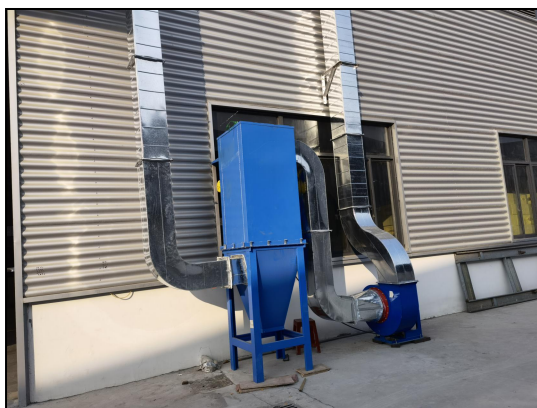
图 4.1-12 脉冲滤筒除尘器
