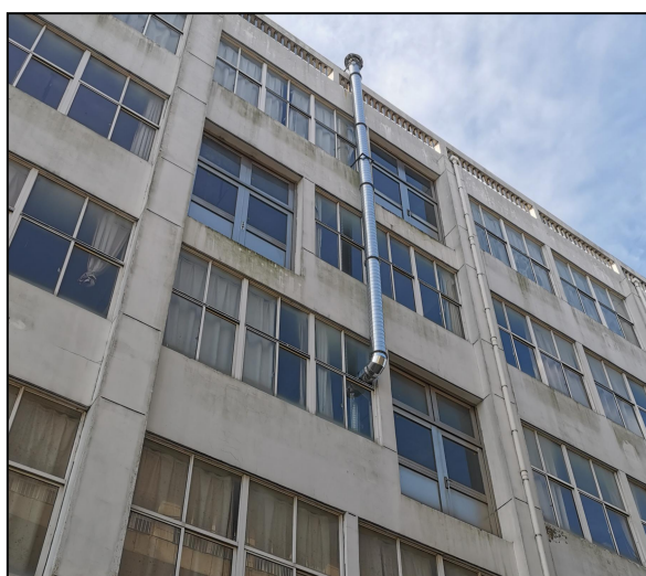
图 4.1-6 15m 高排气筒（DA002 排气筒）
