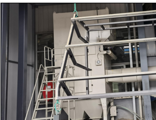
图 4.1-42 脉冲滤芯回收装置 (3#)
