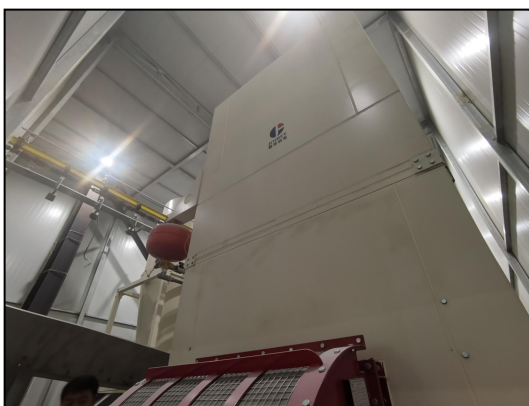
图 4.1-48 脉冲滤芯回收装置（4#）
