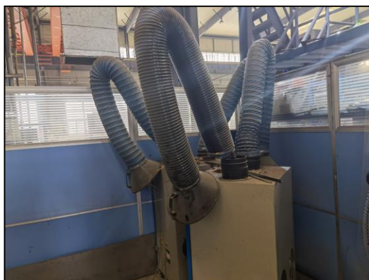
图 4.1-6 移动式焊接烟尘净化器
