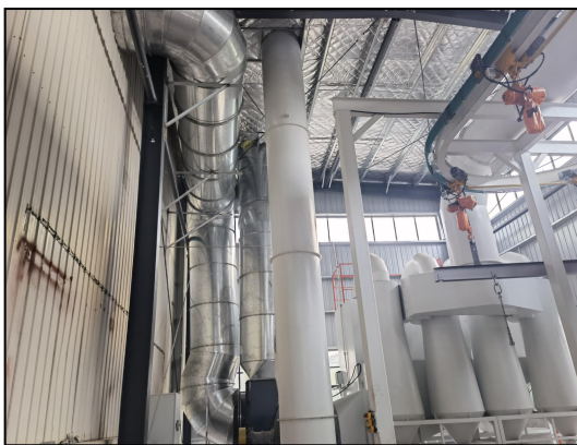
图 4.1-27 滤芯除尘装置
