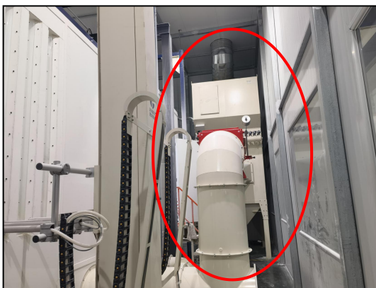
图 4.1-38 脉冲滤芯回收装置 (1#)
