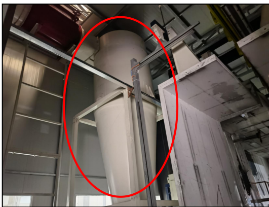
图 4.1-40 脉冲滤芯回收装置 (2#)
