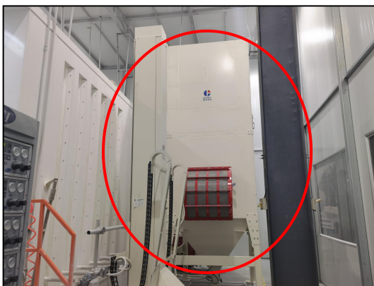
图 4.1-50 脉冲滤芯回收装置（5#）
