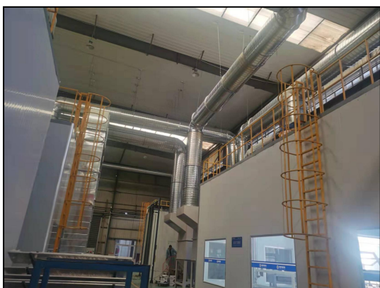
图 4.1-33 打磨房废气管线
