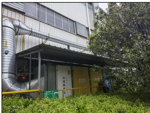
图 4.2-6 注塑废气处理装置
