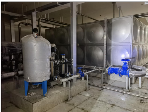
图 4.1-7 水泵房专用设备房
