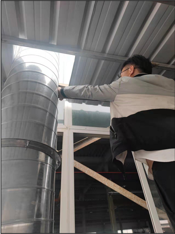
图 5-5 有组织废气监测照片 (DA005 排气筒进口)
