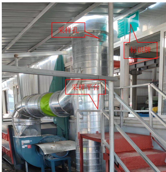
图 4.3-1 DA005 排气筒标识牌、采样平台
