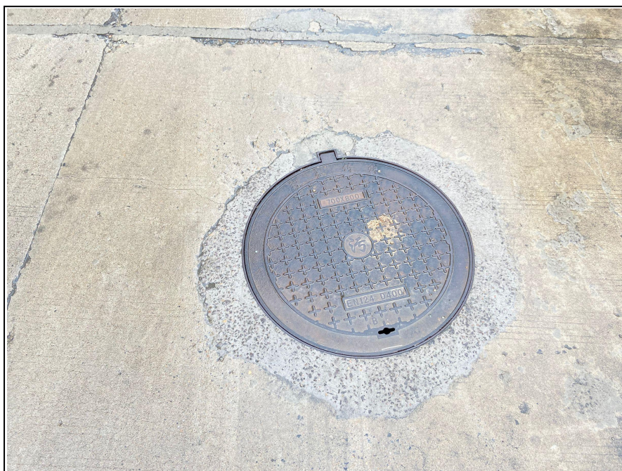
图 4.1-1 厂区化粪池照片
