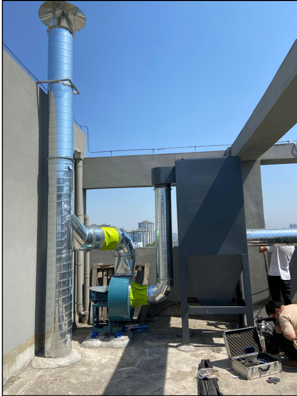
图 4.1-8 布袋除尘器装置+排气筒
