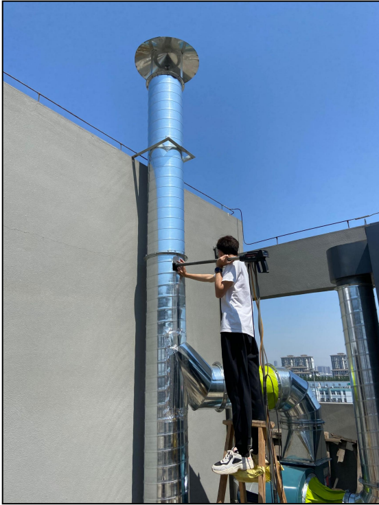
图 5-4 布袋除尘器出口监测照片
