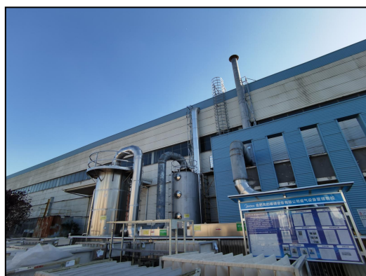
图 4.2-6 3#涂装线废气治理装置
