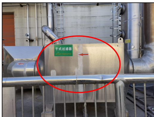
图 4.2-5 2#涂装线干式过滤器
