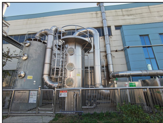
图 4.2-2 1#涂装线废气治理装置
