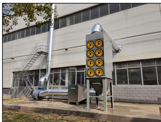
图 4.1-16 滤筒除尘+活性炭吸附装置
