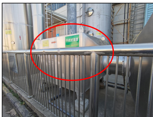
图 4.2-7 3#涂装线干式过滤器
