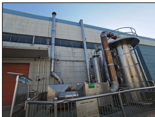
图 4.2-4 2#涂装线废气治理装置
