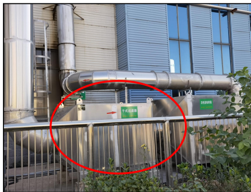
图 4.2-3 1#涂装线干式过滤器
