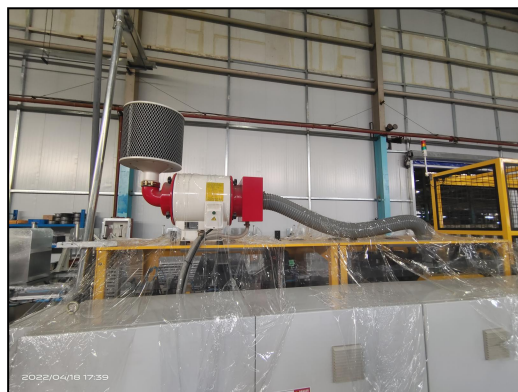
图 4.1-13 油雾回收装置
