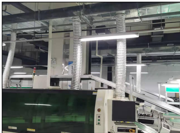
图 4.1-6 波峰焊密闭集气管道
