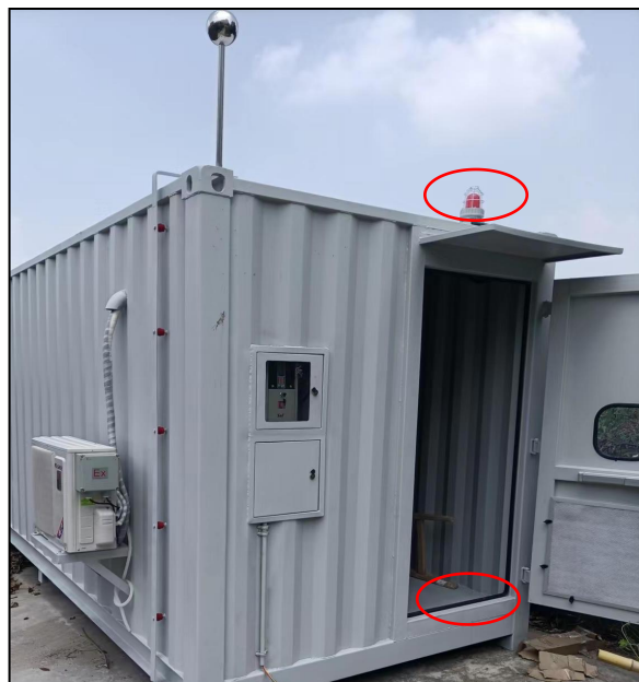
图 4.2-2 危废库（可燃气体报警器、围挡）
