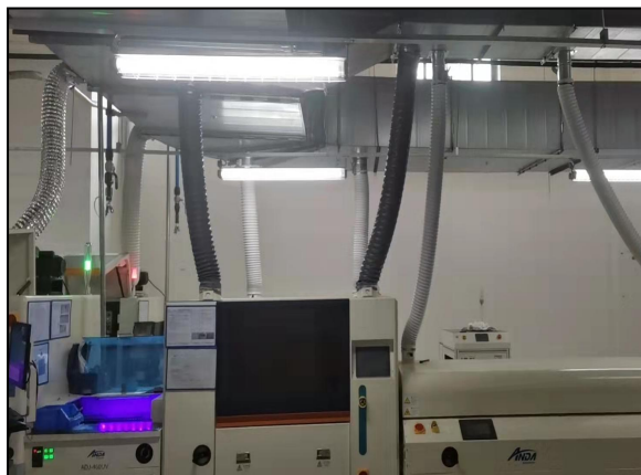
图 4.1-4 丝网印刷工序密闭集气管道
