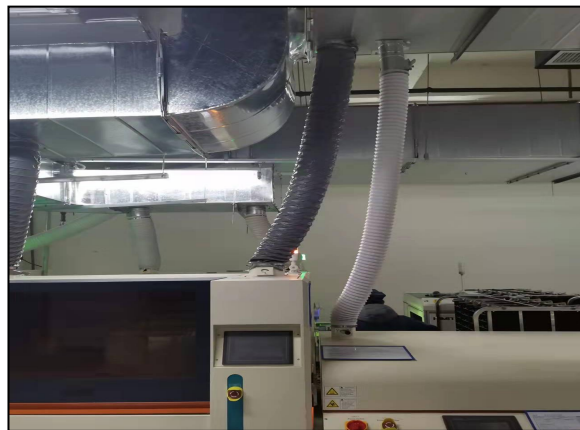
图 4.1-7 喷胶/灌胶密闭集气管道
