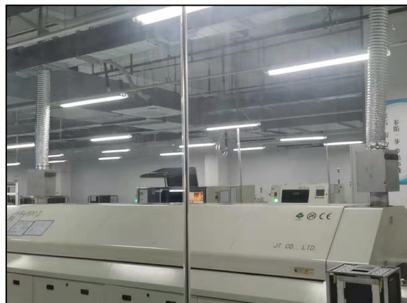
图 4.1-5 回流焊密闭集气管道
