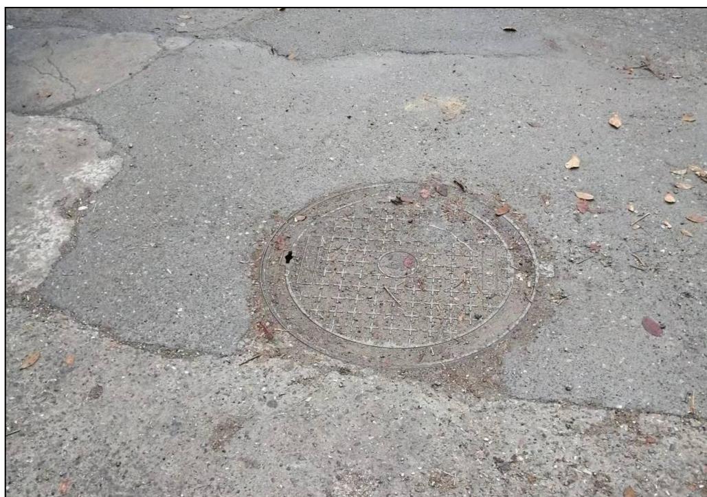
图 4.1-1 厂区化粪池照片
