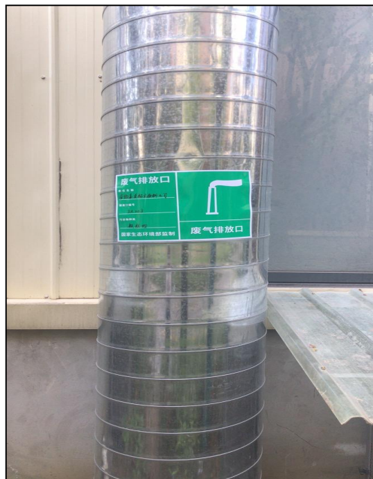
图 4.3-2 DA003 排气筒标识牌
