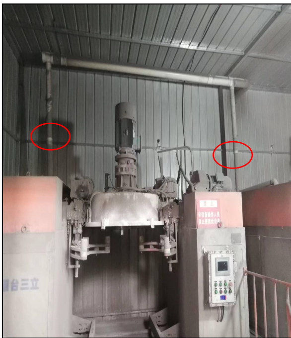
图 4.1-6 混合机房自带收尘装置
