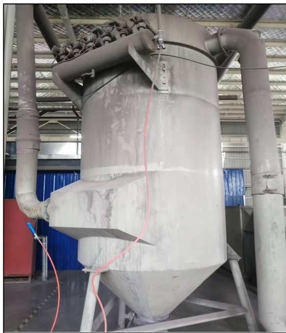
图 4.1-7 1#布袋除尘器（称量配料、投料、混料工序）
