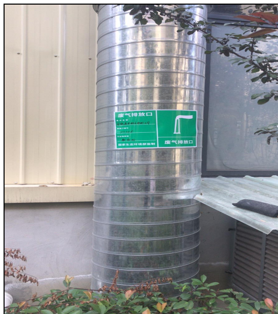
图 4.3-4 DA005 排气筒标识牌
