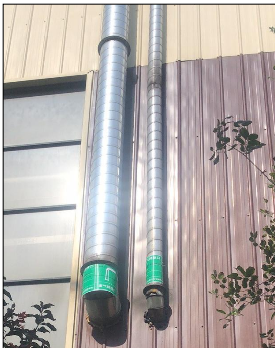
图 4.3-1 DA001、DA002 排气筒标识牌
