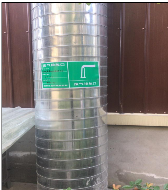
图 4.3-3 DA003 排气筒标识牌
