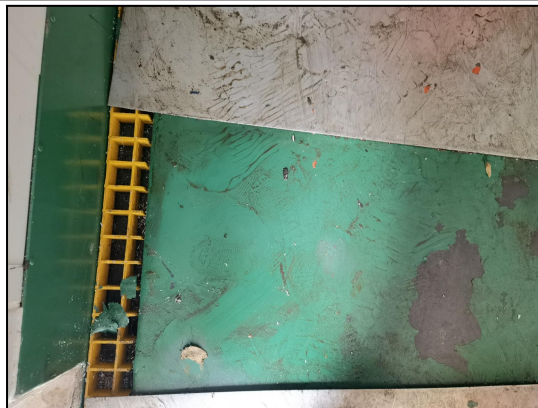
图 4.1-15 危废库收集槽
