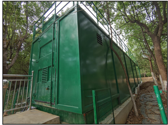
图 4-10 杨林路一体化处理设备
