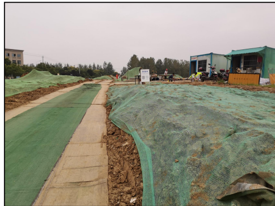
图 4-32 施工期防尘网
