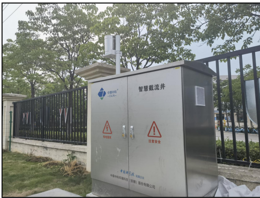
图 4-11 浮山路渠截流井
