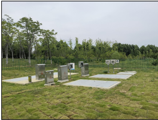
图 4-19 柏堰湖地下初期雨水提升泵站
