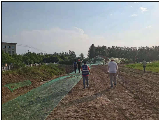
图 4-31 施工期防尘网
