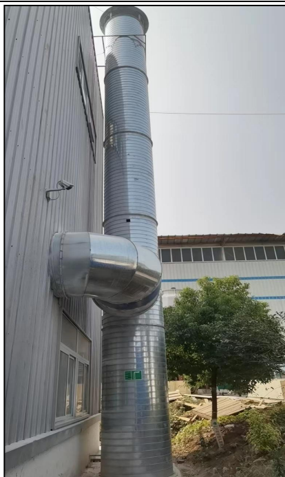
图 4.3-5 DA005 排气筒标识牌
