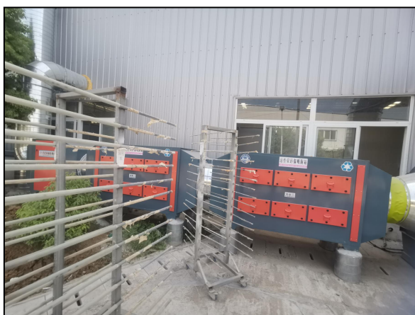
图 4.1-12 过滤棉+二级活性炭吸附装置 (3#)
