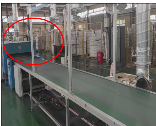
图 4.1-6 收集管道（烘干工序）
