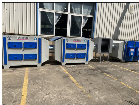
图 4.1-7 油烟净化器+冷凝器+二级活性炭吸附装置
