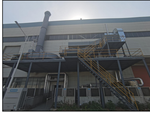
图 4.1-8 干式过滤+二级活性炭吸附装置
