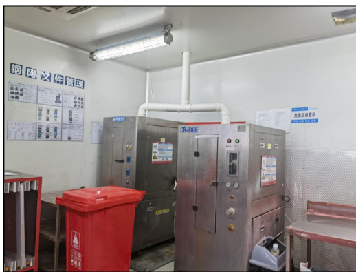
图 4.1-5 钢网清洗集气管
