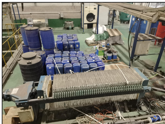
图 4.1-2 污水处理站药剂存放区
