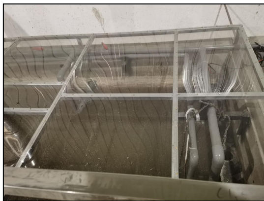
图 4.1-4 水解酸化池、接触氧化池
