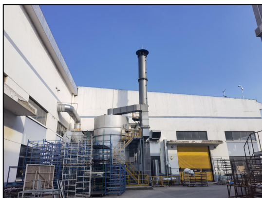
图 4.1-21 RTO 燃烧装置
