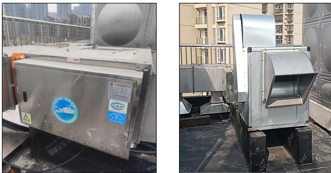
图 5.1-6 油烟净化器及 DA001 排气筒
