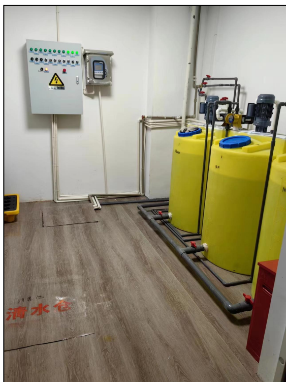
图 5.1-2 污水泵房照片
