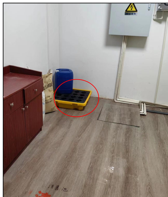
图 5.2-2 污水泵房（防泄漏托盘）
