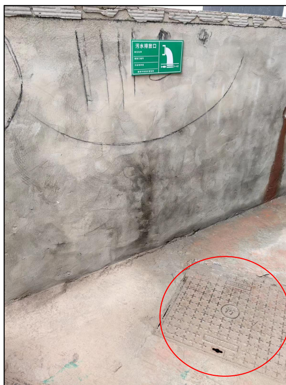
图 5.1-3 污水总排口照片
