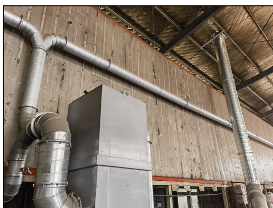
图 4.1-8 固化废气集气管道
