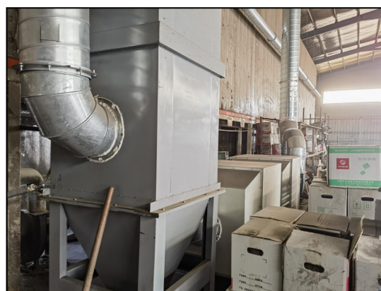
图 4.1-11 高温布袋除尘器+二级活性炭吸附装置
