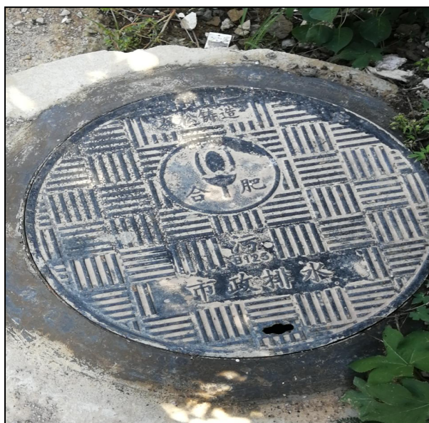
图 4.1-3 厂区污水总排口照片
