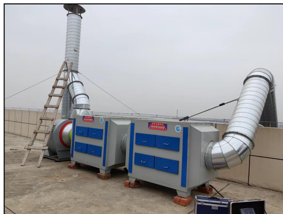
图 4.1-11 二级活性炭吸附装置及 DA001 排气筒
