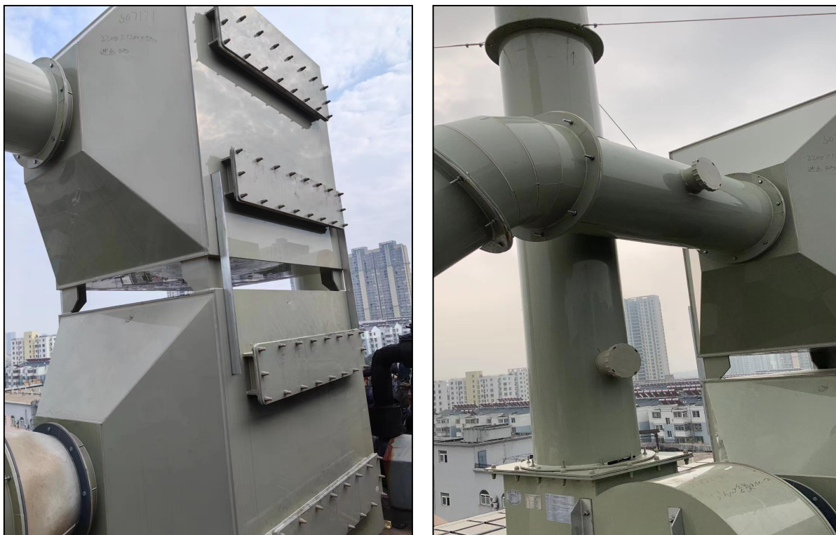
图 4.2-8 二级活性炭吸附装置（1#）及 DA001 排气筒
