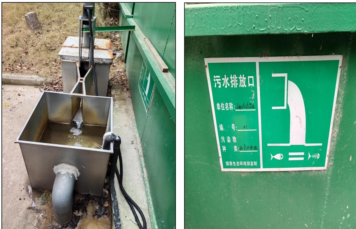
图 4.2-7 污水处理站排放口
