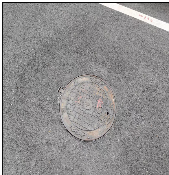
4.1-3 厂区污水排放口
