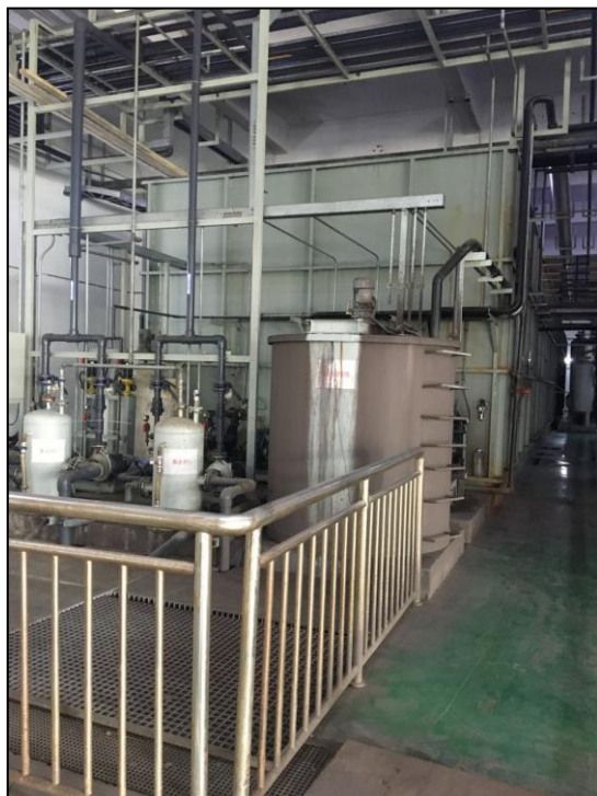
图4.1-5 酸碱废水预处理装置
