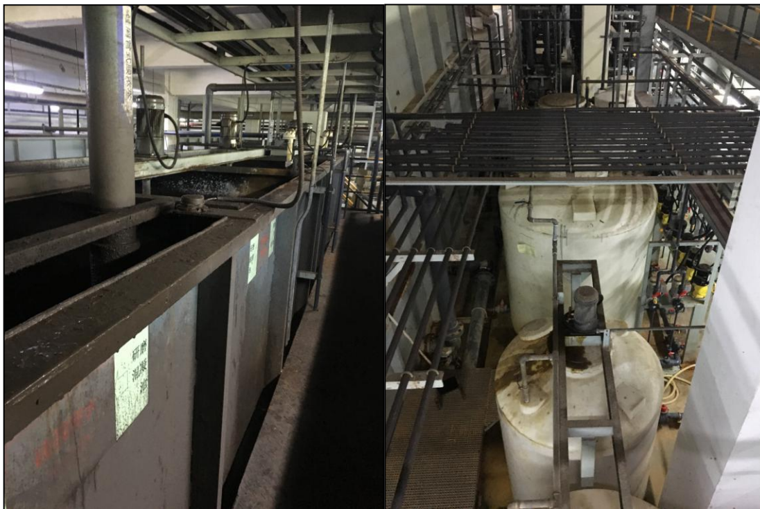
图4.1-7 一般清洗废水预处理装置
