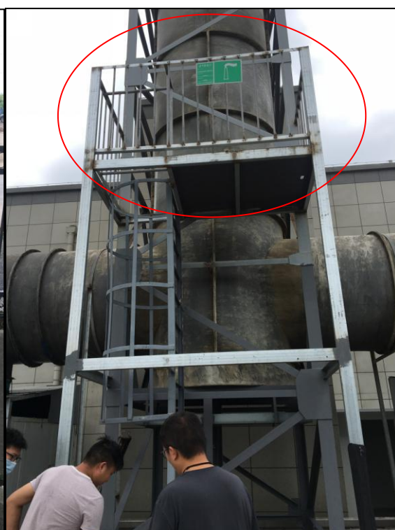
图 4.1-44 废气采样平台
