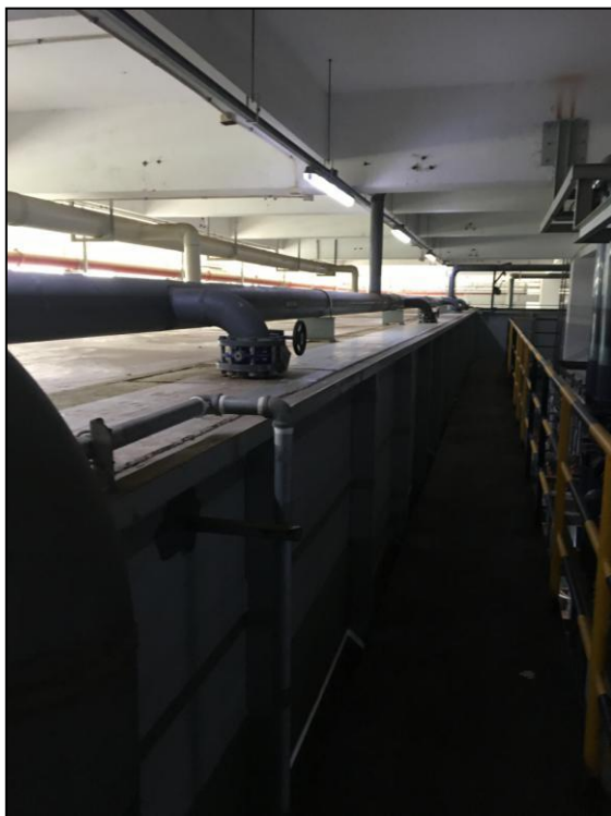
图4.1-23 接触氧化池盖板
