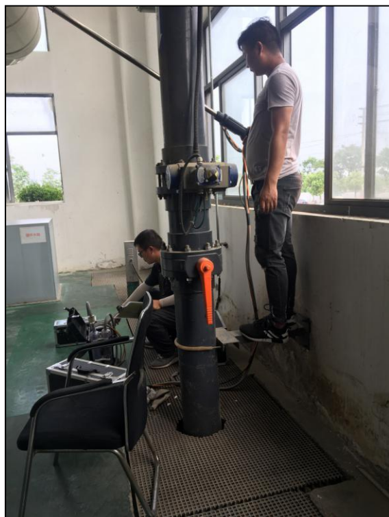
图 4.1-37 污水处理总站切断阀
