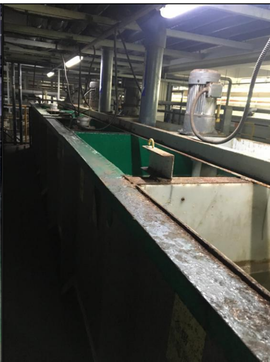
图4.1-6 重金属废水预处理装置
