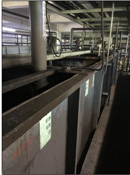
图4.1-3 一般清洗废水预处理装置
