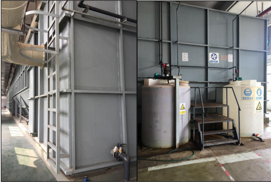
图 4.1-5 污水处理总站
