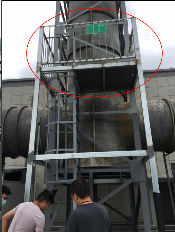
图 4.1-34 废气采样平台
