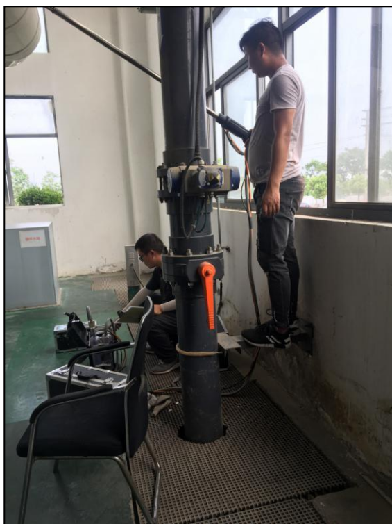
图 4.1-30 污水处理总站切断阀
