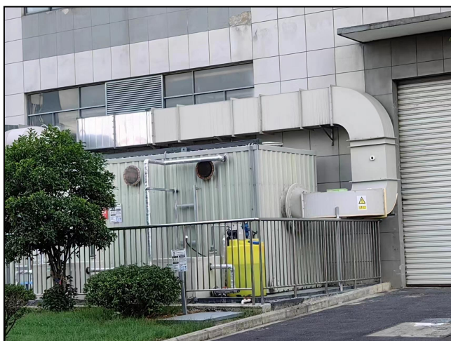
图 4.1-14 生物除臭设施
