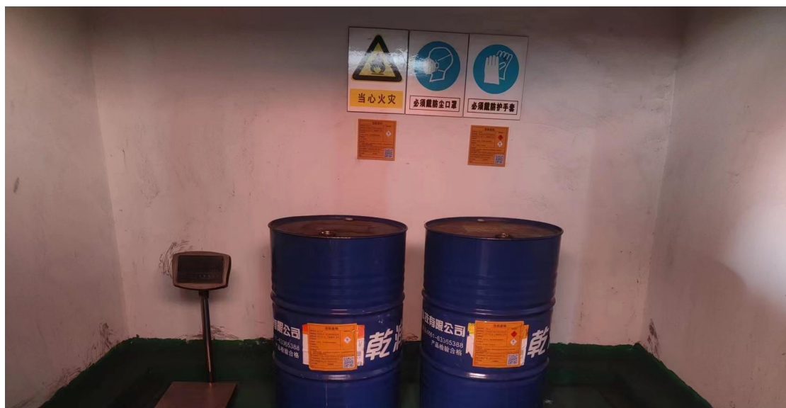
图 4.1-25 危废库防腐防渗、导流沟、收集槽
