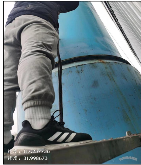
图 2 脉冲布袋除尘器出口
