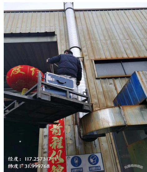
图 4 布袋除尘器出口
