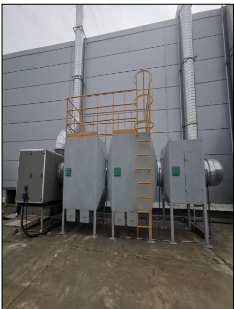
图 4.1-10 干式过滤器+二级活性炭吸附装置 (TA001)
