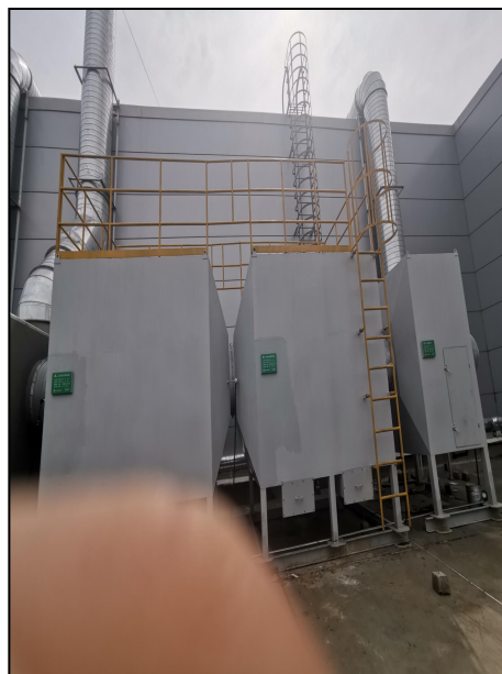
图 4.1-21 干式过滤器+二级活性炭吸附装置 (TA003)
