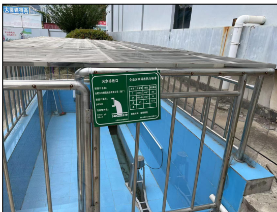
图 4.2-11 污水处理站排放口 (标识牌)
