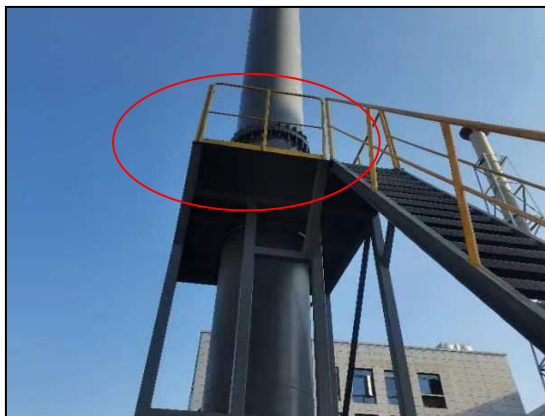
图 4.2-5 RTO 燃烧装置废气取样平台
