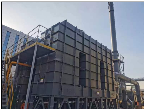
图 4.2-4 RTO 燃烧装置
