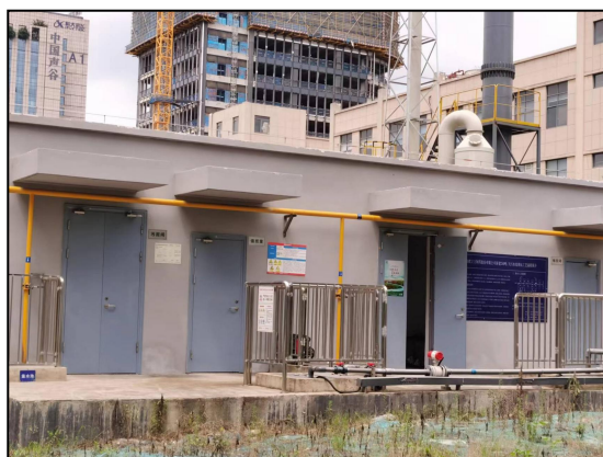
图 4.1-4 污水处理站照片
