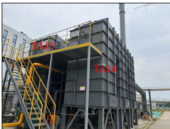
图 4.1-10 RTO 燃烧装置 (TA14~TA15)
