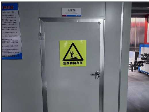
图4.1-29 危废库门口标识牌
