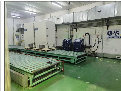
图 4.2-18 配气房通风装置
