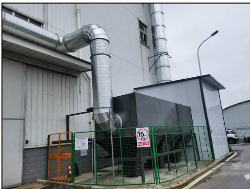
图 4.1-18 滤筒除尘器 (TA003)
