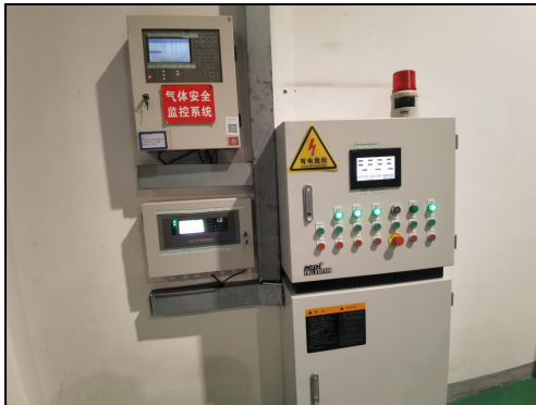
图 4.2-17 气体安全监控系统
