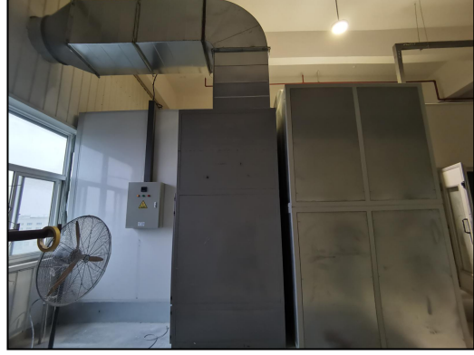
图 4.1-27 过滤棉+二级活性炭吸附装置 (TA005)
