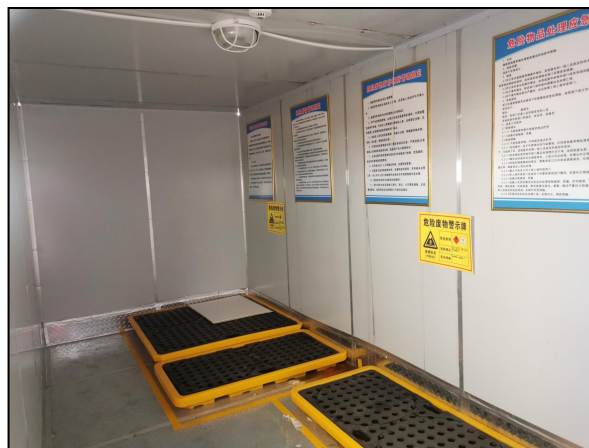
图 4.2-1 危废库（防泄漏托盘、管理制度）
