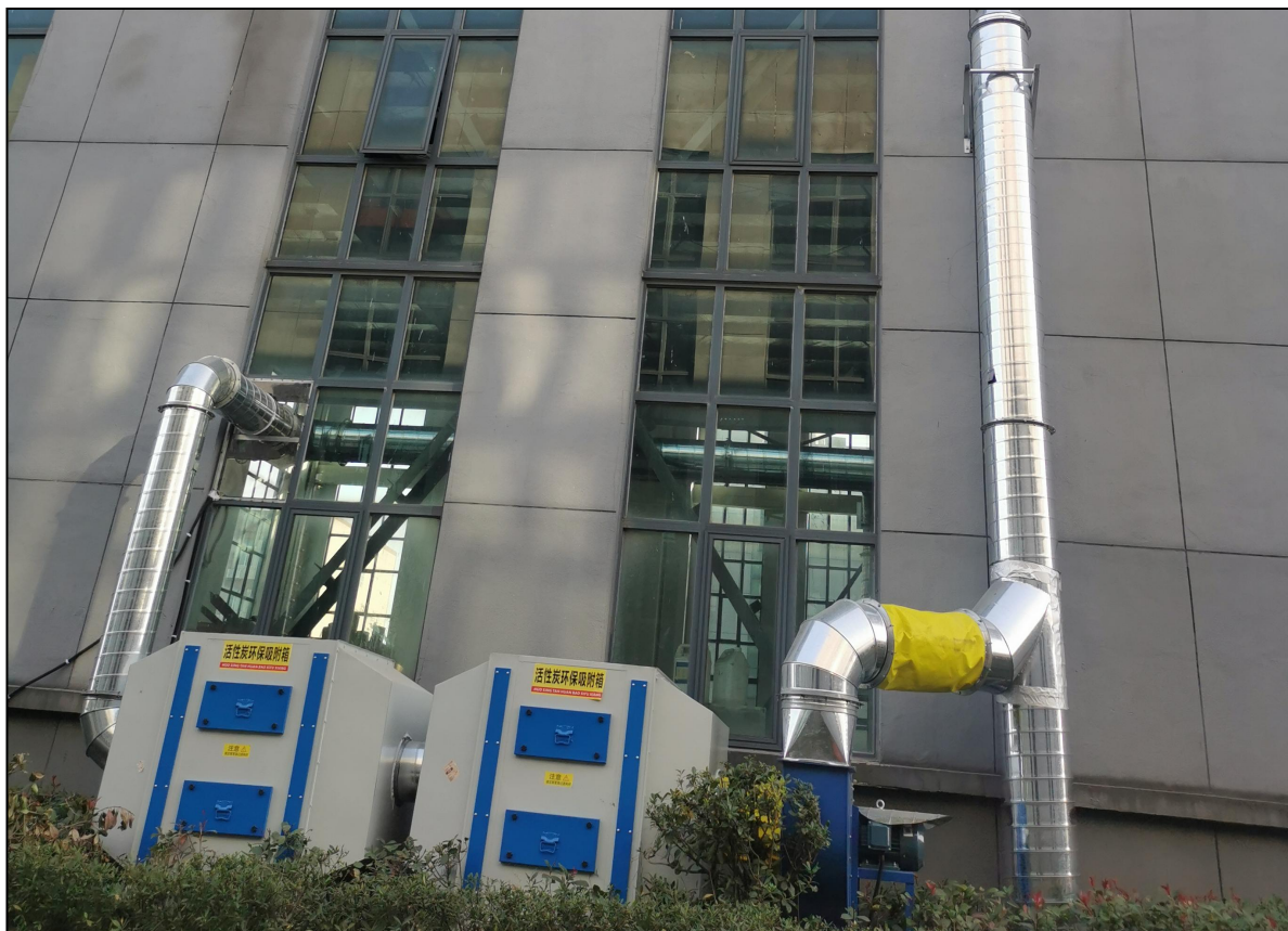
图 4.1-5 二级活性炭吸附装置 (TA001) 及 DA001 排气筒
