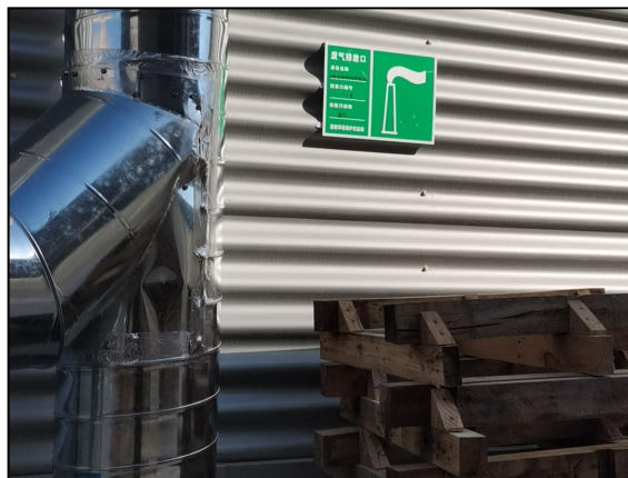
4.1-12 废气排放口标识
