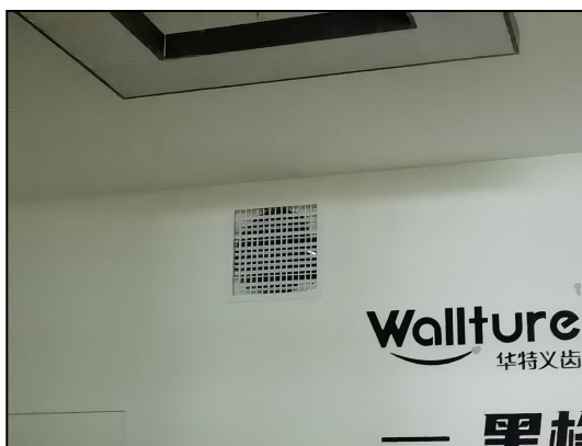
图 4.1-10 模型打印室负压收集口
