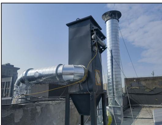
图 4.1-7 脉冲除尘器 (TA003) + 排气筒 (DA003)
