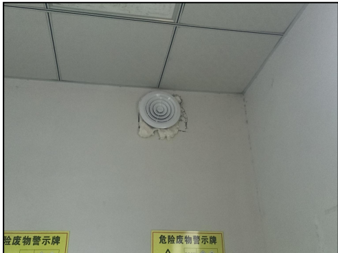
图 4.2-5 危废库废气收集口
