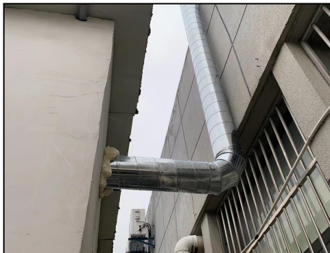
图 4.2-6 危废库废气管道
