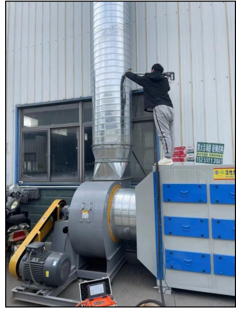
图 4-2 有组织废气监测照片 (DA002 排气筒出口)
