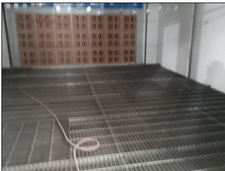
图 4.1-8 1#喷漆房内部干式过滤
