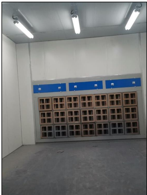
图 4.1-6 2#喷漆房内部干式过滤
