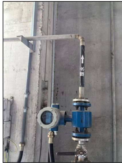
图 4.2-12 厂区内废水收集管道
