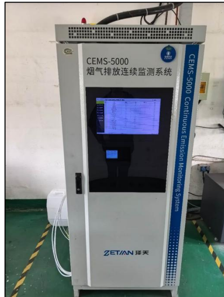
图 4.2-19 废气 CEMS 在线监测设备
