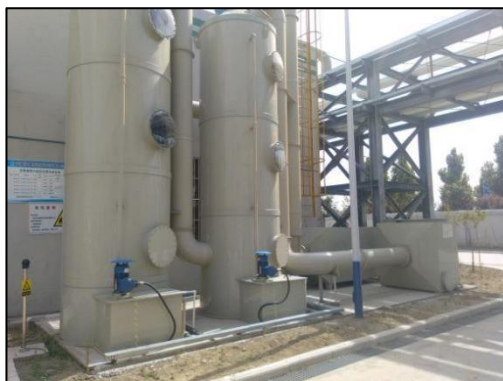
图 4.1-14 危废库（二级碱吸收+活性炭吸附装置）
