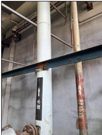
图 4.2-11 厂区内废水收集管道
