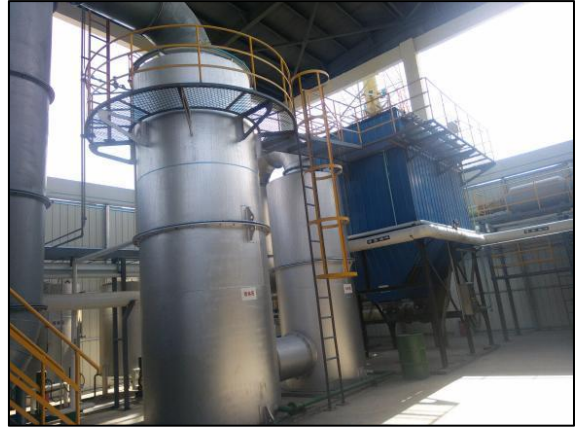
图 4.1-9 焚烧炉废气处理措施
