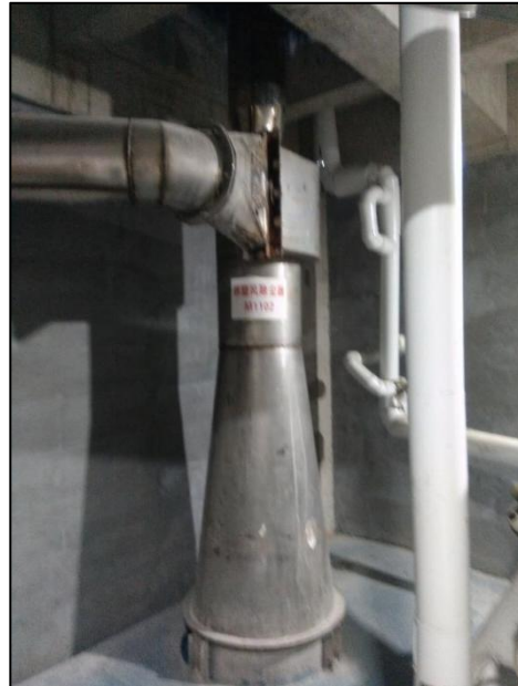
图 4.1-11 切片废气处理装置（旋风除尘器）
