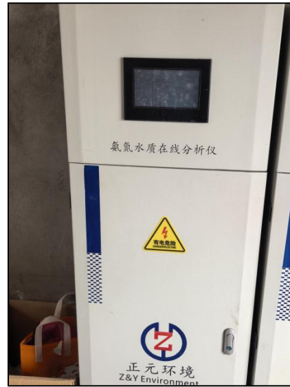
图 4.1-3 氨氮在线监测装置照片
