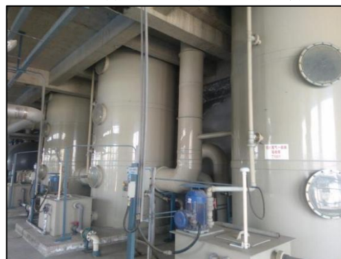
图 4.1-13 切片废气处理装置（三级碱液喷淋塔）
