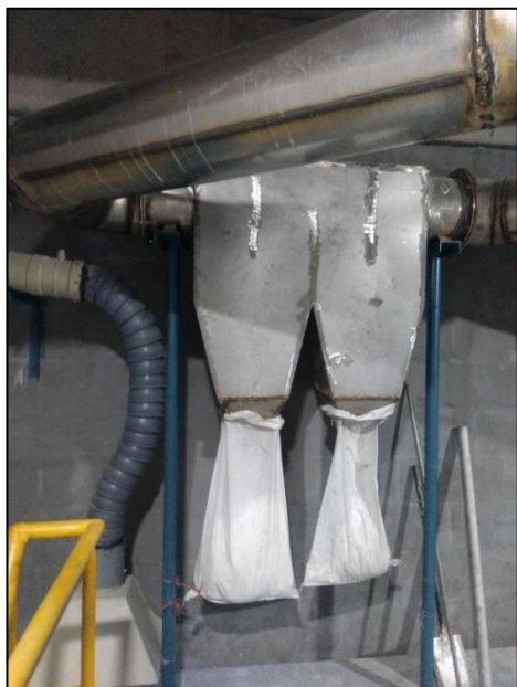
图 4.1-10 切片废气处理装置（重力除尘器）
