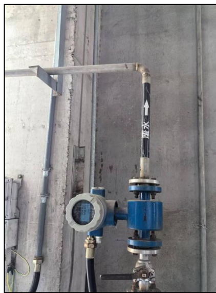
图 4.2-12 厂区废水收集管道
