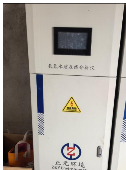
图 4.1-3 氨氮在线监测装置照片
