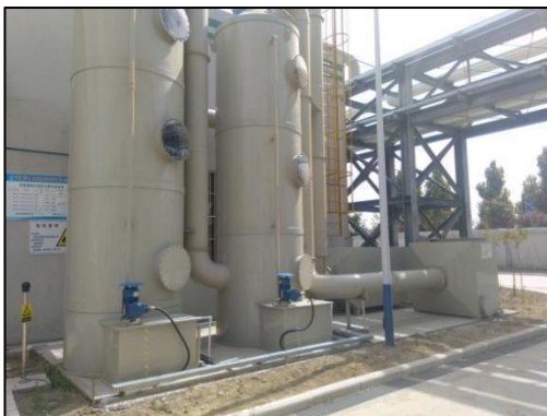
图 4.1-14 危废库（二级碱吸收+活性炭吸附装置）
