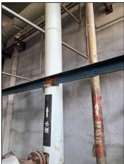
图 4.2-11 厂区废水收集管道
