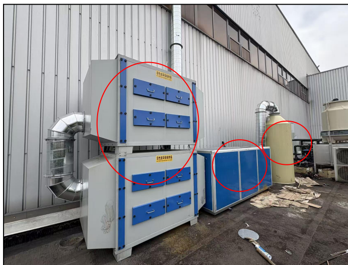
图 4.1-5 喷淋塔 (TA001) +油雾净化器 (TA002) +二级活性炭吸附装置 (TA003)
