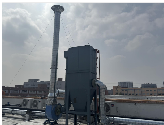
图 4.1-8 布袋除尘器（TA002）+DA002
