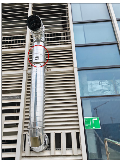
图 4.2-1 DA001 排气筒标识及监测孔
