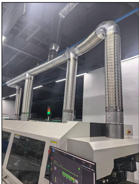
图 4.1-2 波峰焊废气集气管道
