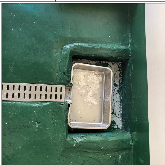
图 4.1-11 危废库导流沟+集液槽
