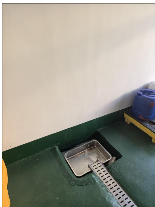
图 4.2-1 化学品中转仓导流沟、集液槽
