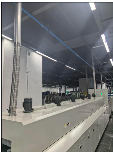
图 4.1-7 灌胶固化废气集气管道
