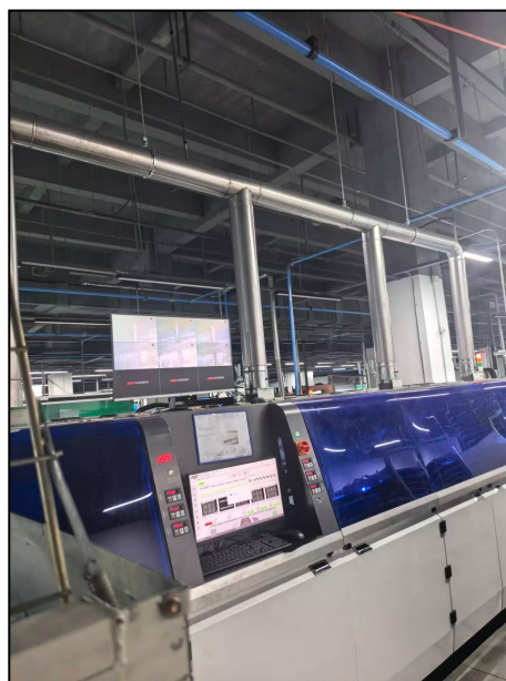
图 4.1-5 选焊废气集气管道
