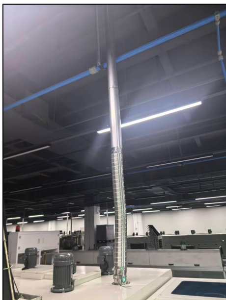
图 4.1-6 灌胶废气集气管道
